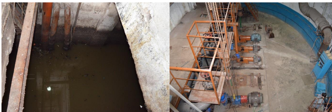
Figura 4-16: Stația de pompare principală a apelor uzate: bazin de recepție, sala motoarelor
