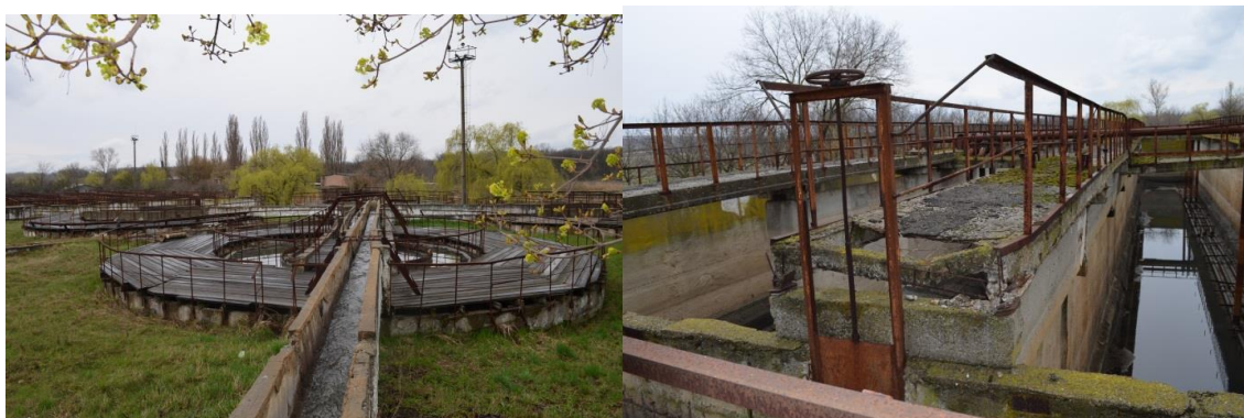
Figura 4-18: Stația de epurare a apelor uzate: Limpezitor-fermentator. Bazin de aerare cu nămol activ (BANA)
