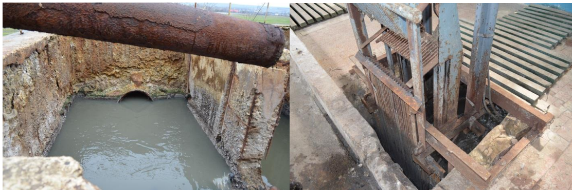
Figura 4-17: Stația de epurare a apelor uzate: Disipatorul de energie. Grătarele mecanice
