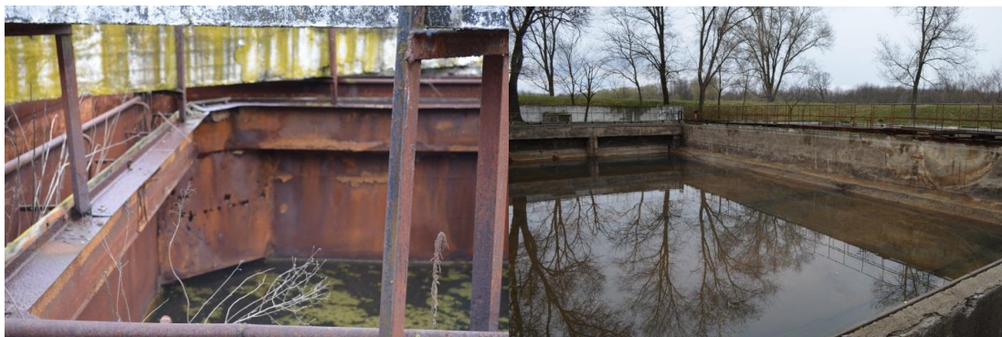
Figura 4-19: Stația de epurare a apelor uzate: Decantoare secundare. Bazinul de contact
