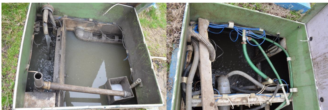
Figura 4-22: Stația de epurare a apelor uzate din satul Petrești
