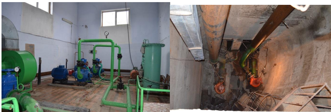
Figura 4-3: Captarea apei brute. Grupul de pompe SEWATEC K200-4006-SEN 225M04. Grupul de pompe FA 15.84 DEMI-250/20
