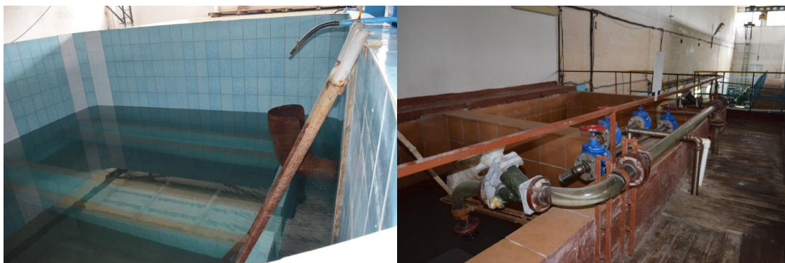
Figura 4-5: Stația de tratare a apei. Filtrul rapid deschis. Gospodăria de reactivi
